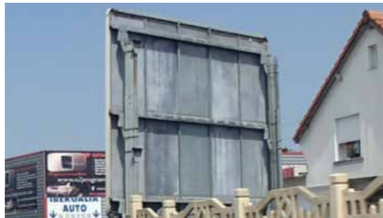
DÉFAUT D'HABILLAGE DU DOS
